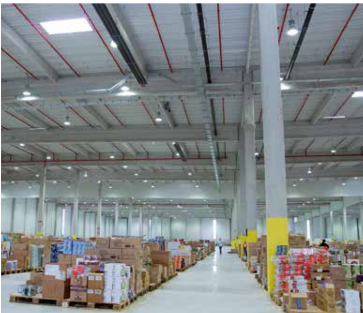
Distributionszentrum mit Dunkelstrahlern
