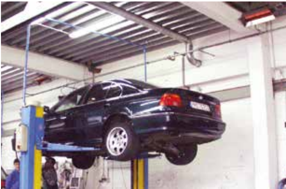
Hellstrahler in Autowerkstatt
