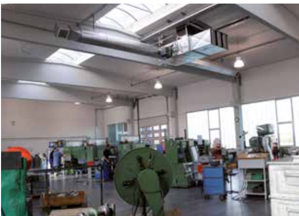
Warmluft- und Lüftungssystem als Deckenmontage
