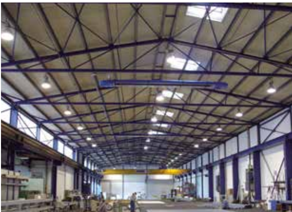
Metallbearbeitungshalle mit Dunkelstrahlern
