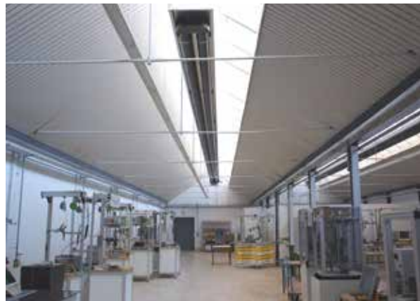
Werkhalle mit Dunkelstrahlern
